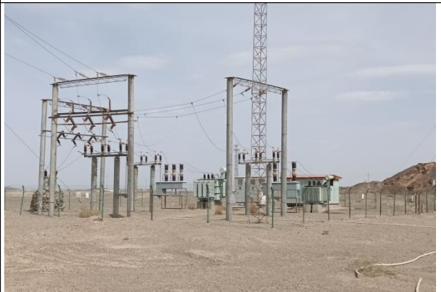
项目供电系统
