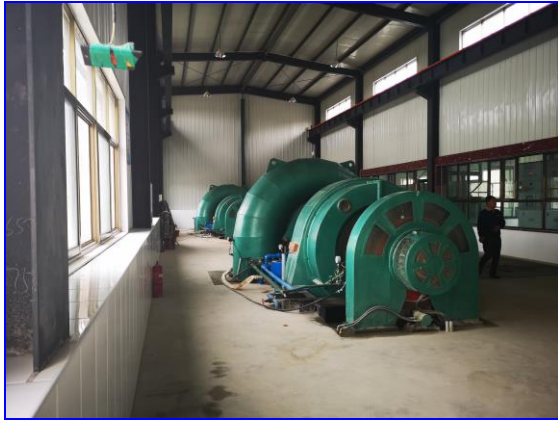
水电站发电厂房内景
